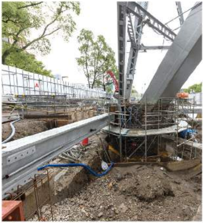
柱脚とその広がりを抑える新設のタイバー
