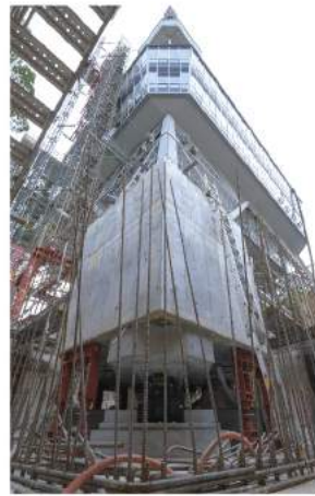
柱脚下に設置された免震装置
